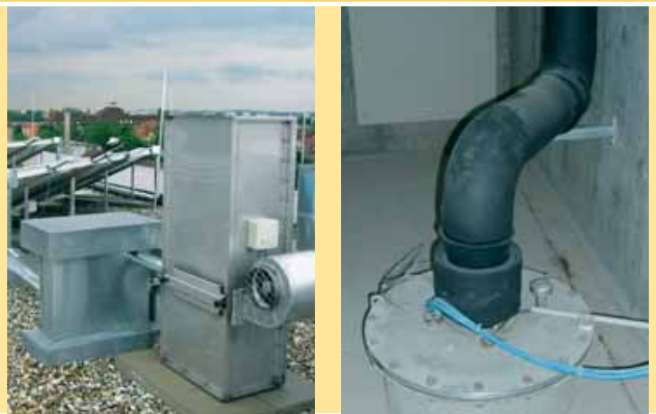
Abb. 17 Nasskühlturm im Fraunhofer SOBIC (im Solar Info Center Freiburg, links) und Brunnenkopf des Saugbrunnens (im Fußpunkt eines Steigschachtes im Gebäude der GMS Biberach, rechts). Fotos: solares bauen GmbH und Hochschule Biberach
